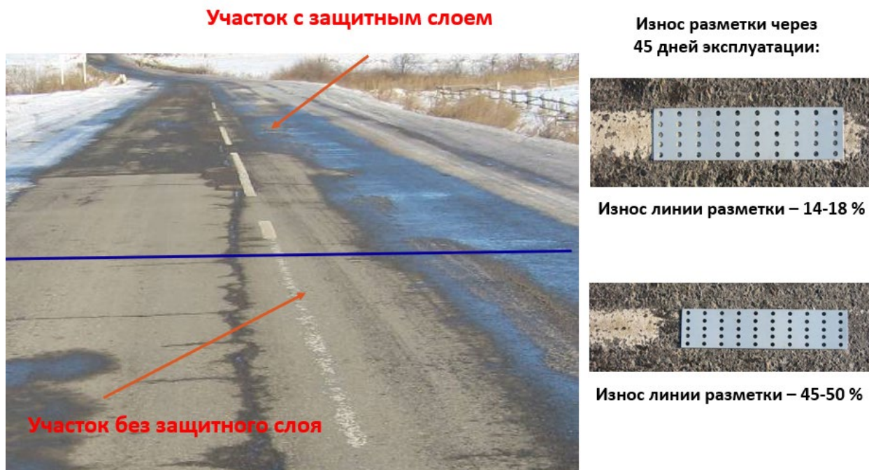
Рис. 1. – Износ дорожной разметки
